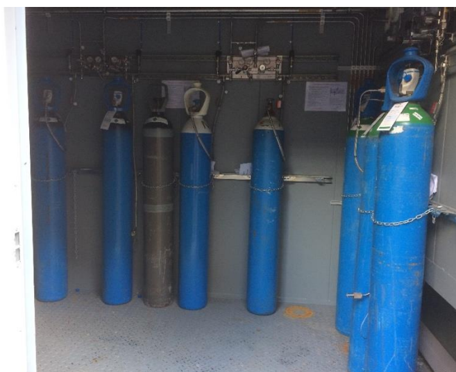
Figur 3: Gascontainern norra, interiör.
