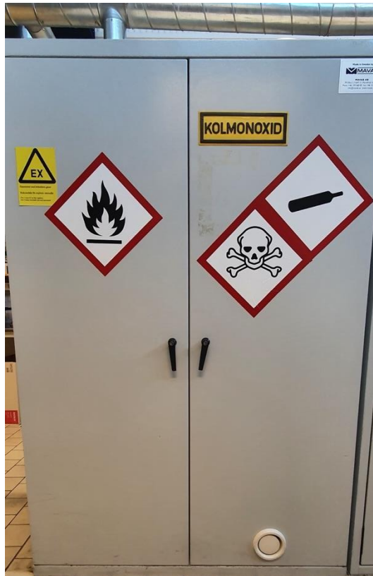
Figur 4. Exempel på ett godkänt brandskyddat gasskåp (EN 14470-2 standard).
