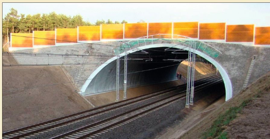
Bilden visar en större rörbro, ett exempel på konstruktioner som är möjliga med den beskrivna tekniken.
